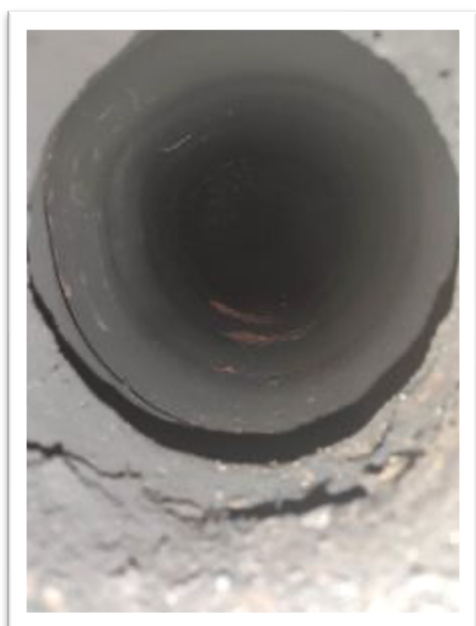
Chambre de combustion avant nettoyage de la suie
